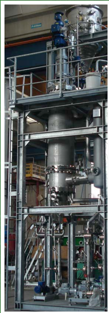
溶剂回收装置
